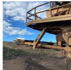
Figura 2 - Condutores expostos na correia
