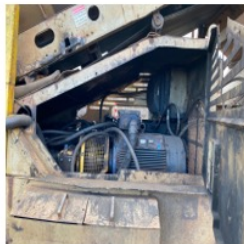
Figura 1 - Condutor em contato com motor
