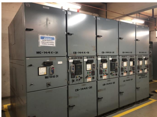
Fig. 2 Painel de 4,16 kV utilizado
