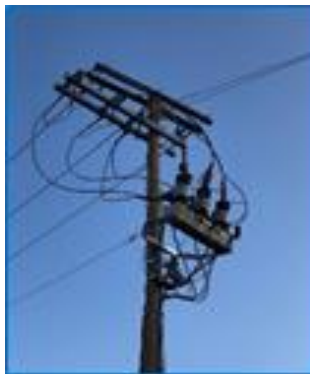
Figura 6 – Religador instalado no poste.
